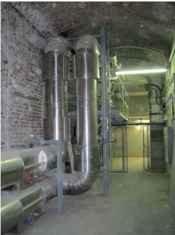
Abb. B.38: Übernahmestation der Fernwärme in der Nordwestecke des 2. Kellers
