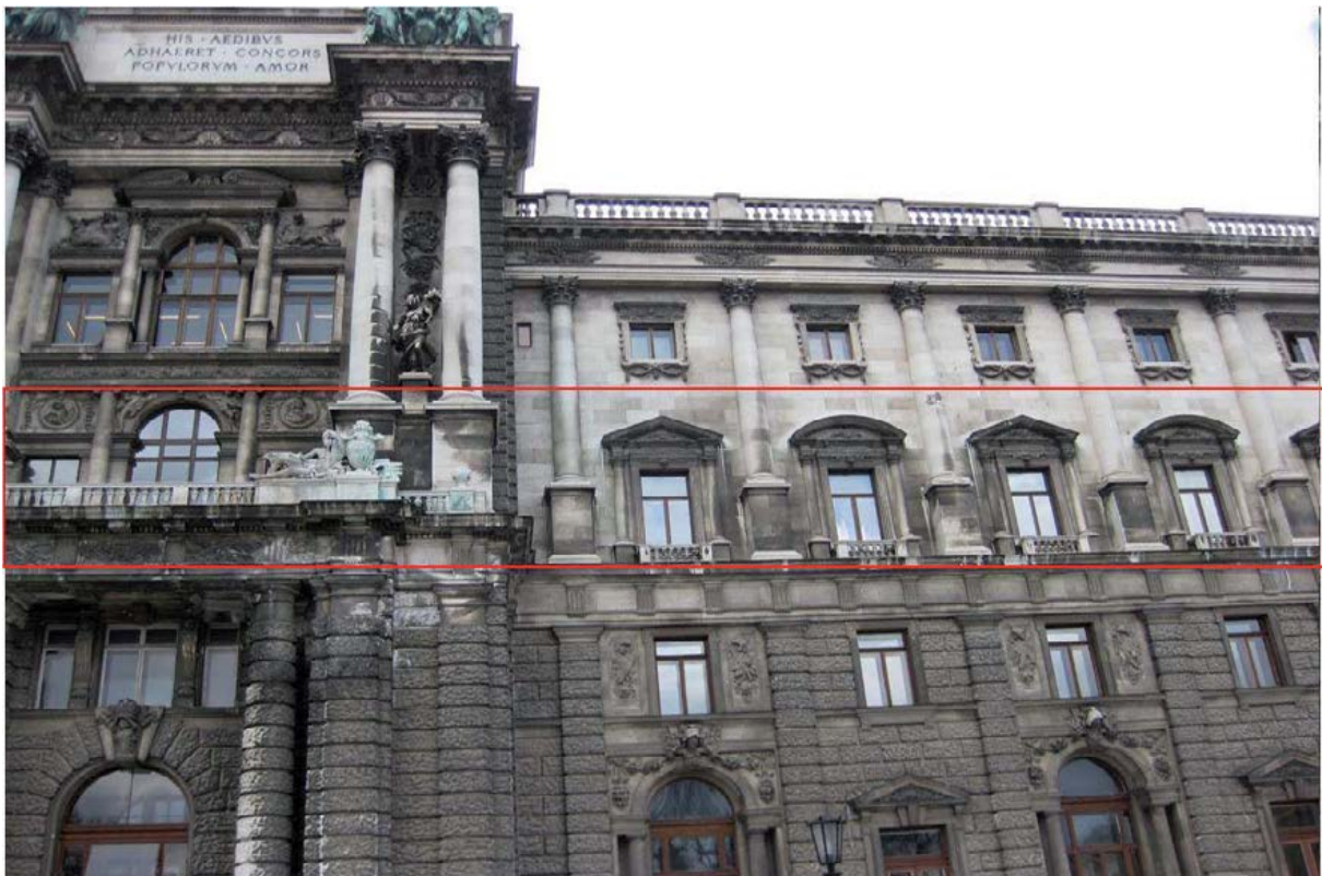
Abb. C.39: Südstfassade der Neuen Burg: Alle Fenster des 1. Stocks sind mit einer fixen Außenbeschattung ausgestattet.
