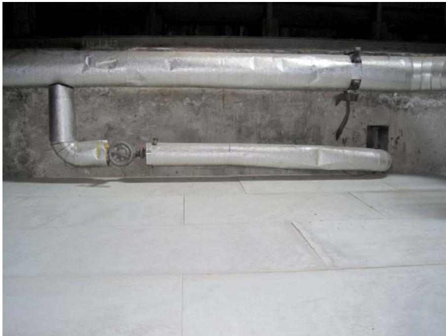
Abb. B.88: Auf dem Dachboden treten die Steigleitungen aus kleinen Schächten aus der Außenwand. Diese Schächte könnten eventuell Teil des ursprünglich geplanten Lüftungs- bzw. Heizungssystems gewesen sein.
