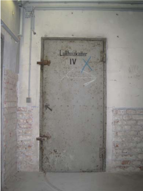
Abb. B.19: Eingang zur Luftheizkammer IV (C-Schacht)
