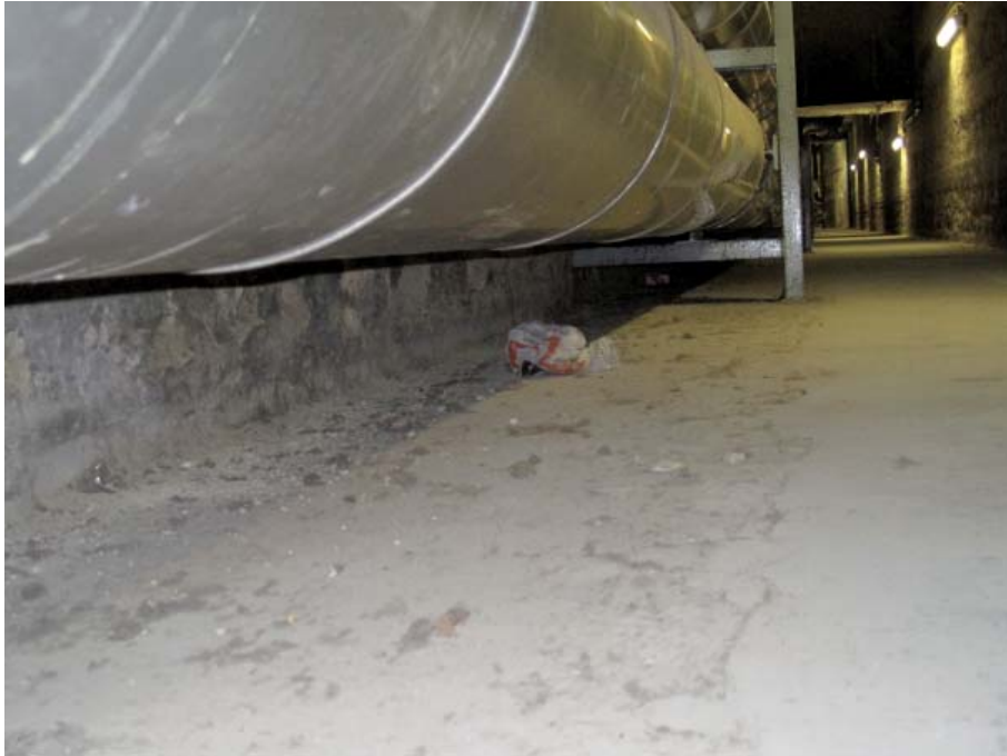
Abb. B.78: Staubablagerungen im Bereich der Fernwärmerohre
