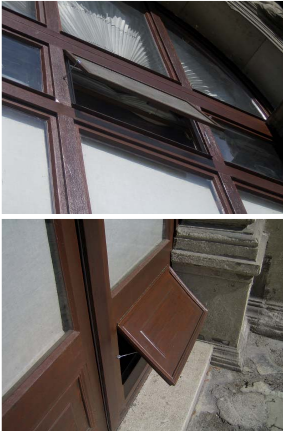
Abb. C.42: Fensterkastenbelüftung bei den großen Rundbogenfenstern/-türen
