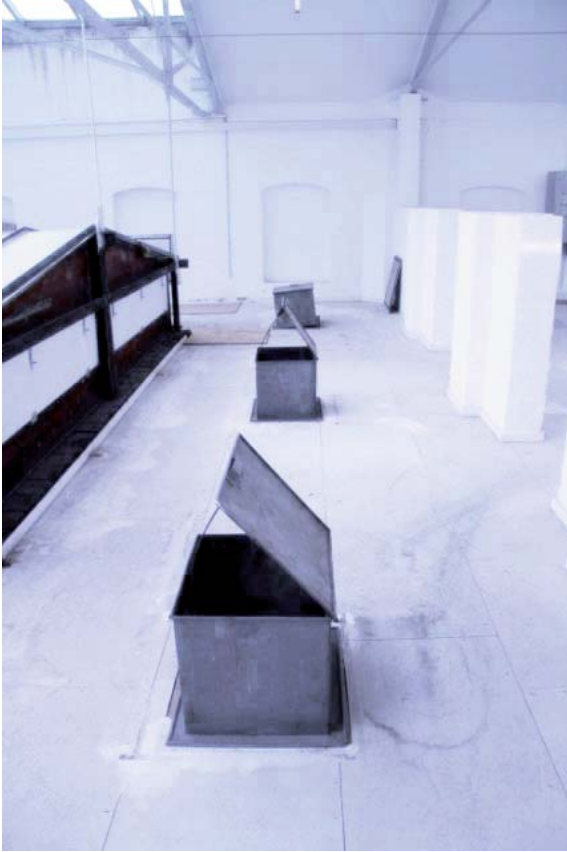
Abb. A.12: Abluftöffnungen und Hinterlüftung des Dachraums im Herzog-Anton-Ulrich-Museum Braunschweig
