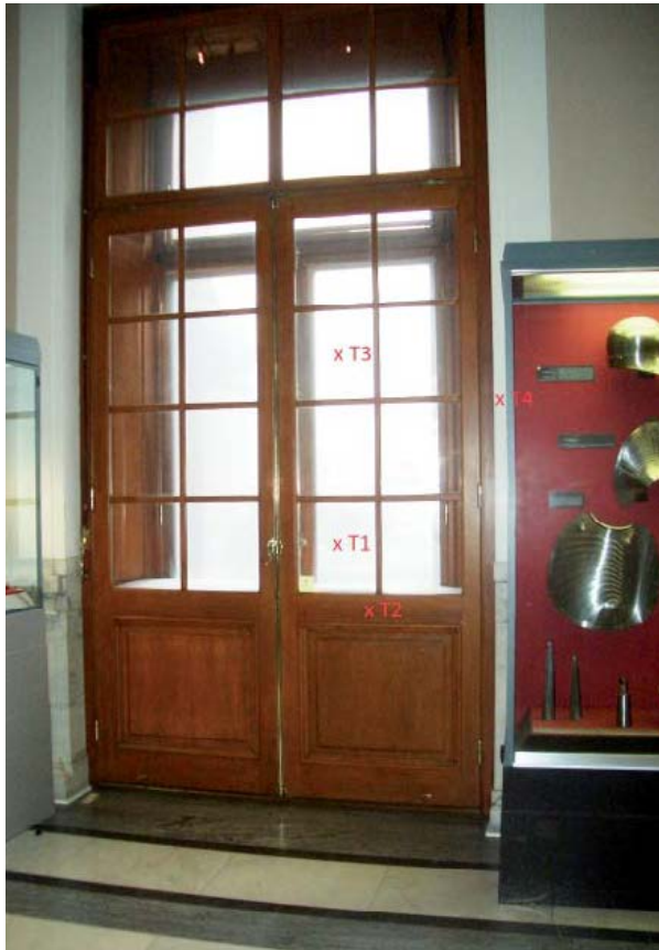
Abb. C.20: Optimierte Tür auf Plateau 1 der Neuen Burg (Dichten der Außenflügel und „Fensterpölster“ im Zwischenraum); markiert sind die Messpunkte T1 - T4 der Thermofühler auf Fenstergläsern, Türrahmen und Laibung
