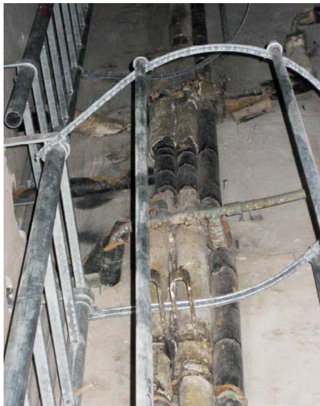
Abb. B.79: In den Steigschächten quillt Dämmmaterial aus der Ummantelung der alten Heizrohre. Der Verputz ist teilweise lose und sandet ab.
