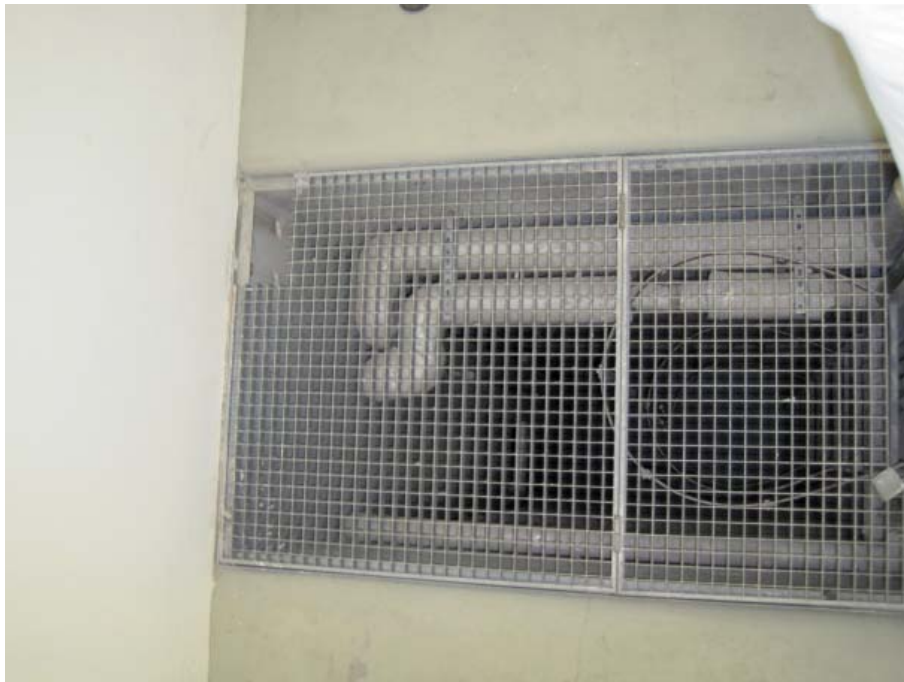
Abb. C.12: Zur kontrollierten natürlichen Belüftung der Säulenhalle (Aula) muss die Nachströmöffnung zwischen 2. Keller und innerem Kellerrundgang mit einer elektrisch angesteuerten Jalousienklappe ausgestattet werden.
