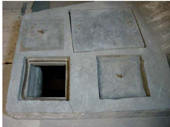
Abb. A.13: Ehemalige Abluftöffnungen in den Dachraum im Städtischen Museum Braunschweig (Dr. A. Walz, HAUM Braunschweig)
