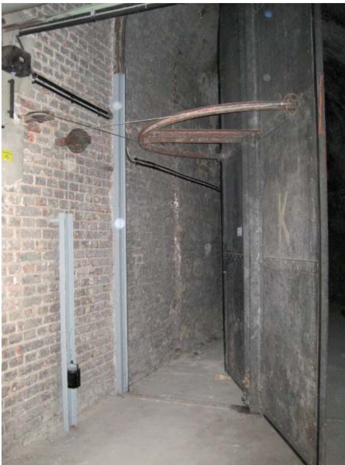
Abb. C.10: Die Drehtür am Eingang in den 2. Keller dient als zentrale Drosselklappe für die Zuluft und wird von dem im Nachbarraum befindlichen 17 kg-Gewicht geschlossen. Das sichtbare 8 kg-Gewicht öffnet (beim Entlasten des Schließgewichts) die Drehtür.
