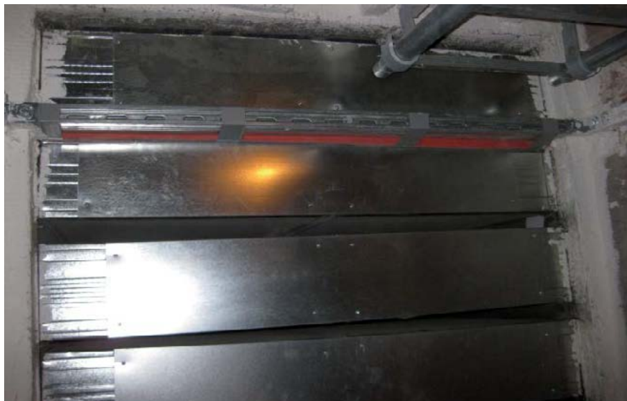
Abb. B.50: Die Abluftventilatoren der vier großen Lüftungsschächte sitzen direkt auf der Schachtmündung. Der Querschnitt des Schachtes wird von den Schalldämpfern um ca. 80 % vermindert und dadurch der freie Auftrieb behindert.
