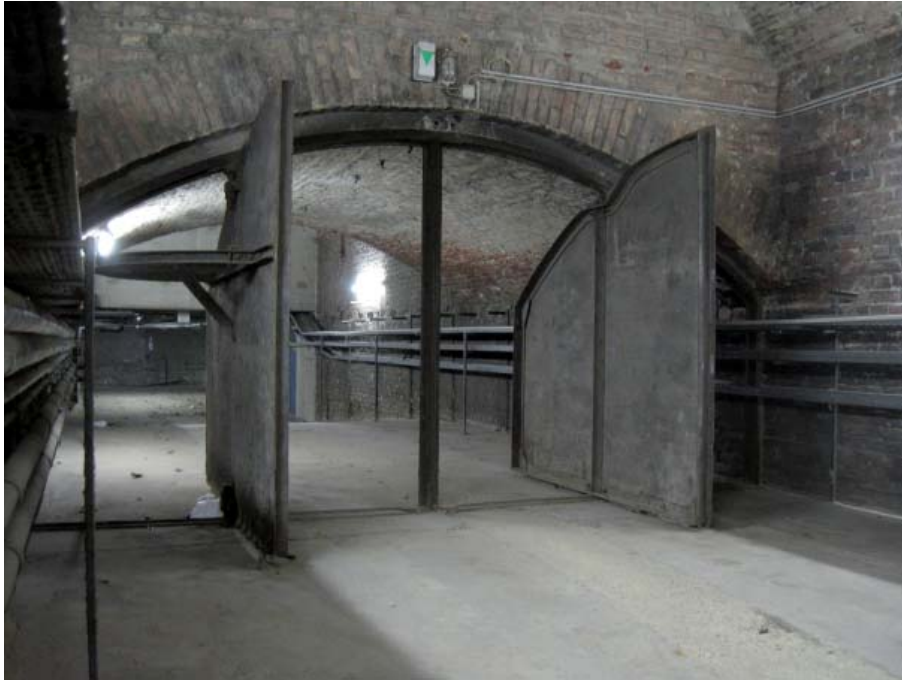
Abb. B.15: Doppeldrehtür im Lufteinlass zum 2. Keller
