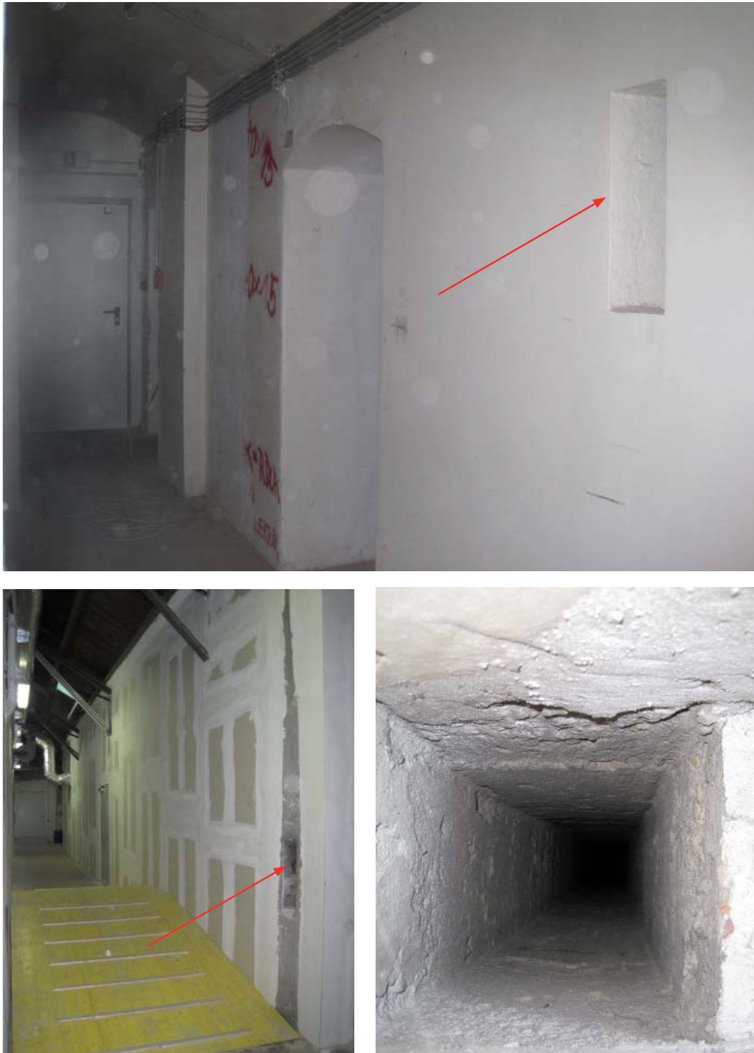
Abb. B.72: Korrespondierende ehemalige Lüftungsöffnungen zwischen 1. Keller (links) und Dachboden (oben) zur Hinterlüftung des Dachraums. Der Schacht erscheint von unten frei, ist aber irgendwo dazwischen abgemauert (rechts)
