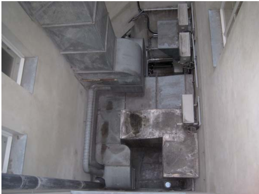
Abb. B.51: Klimageräte im Lichthof E der Neuen Burg. Abwärme und Lärm verhindern für die anderen Anrainer ein adäquates Lüftungsverhalten.
