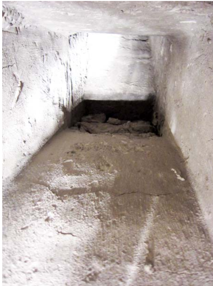
Abb. B.66: In Schacht Nr. 25 befindet sich ca. 50 cm über Fußbodenniveau eine zugemauerte Öffnung
